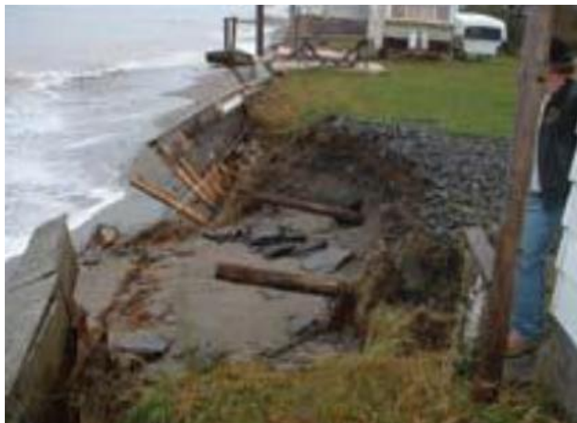
Figure 57: Érosion sévère créée derrière le mur par le franchissement de l'eau lors d'une tempête. Source : UQAR, 2010
