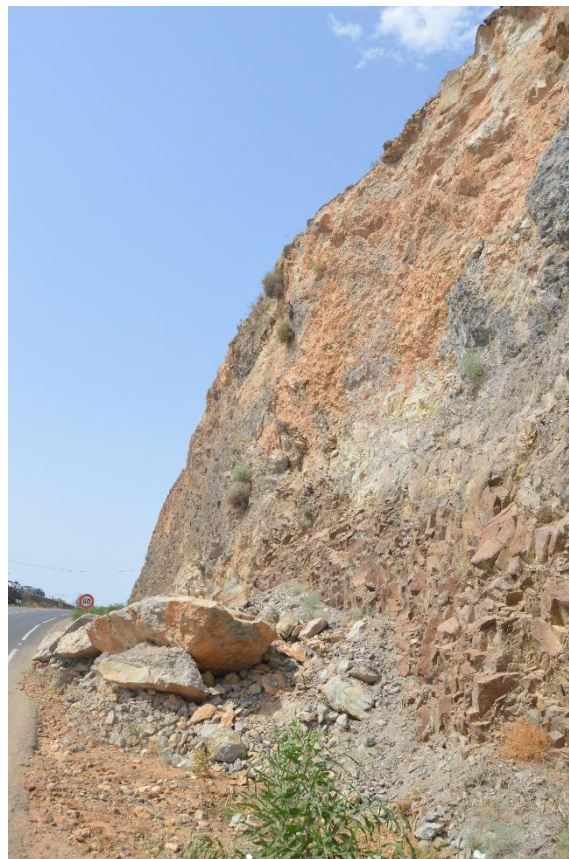
Figure 16: Chute d'un bloc rocheux sur la rocade méditerranéenne (M. TAHER 2026)
