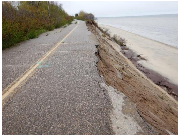
Figure 51: Côte à falaise meuble et peu consolidée en érosion. Source : MSP, 2023
